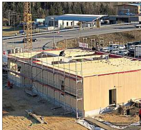
Aus Massivholzwänden wurde das Gebäude für Burgerking in Hutthurm gebaut. Jetzt folgen Innenausbau und Außenanlagen. Die ersten Burger soll es dort Ende Mai geben. – Foto: Veit & Fröhler
