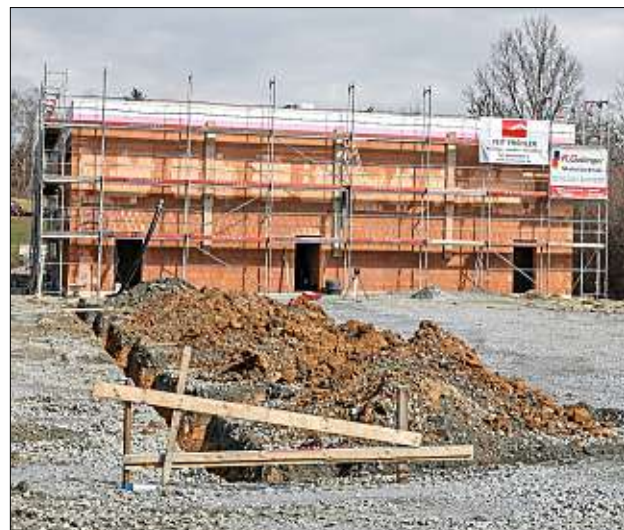
Der Sozialtrakt steht schon , die große Fahrzeughalle folgt als nächstes. Bis Juni soll die neue Niederlassung des Rettungsdienstes Stadler an der B 12 fertig sein. – Foto: Jäger
